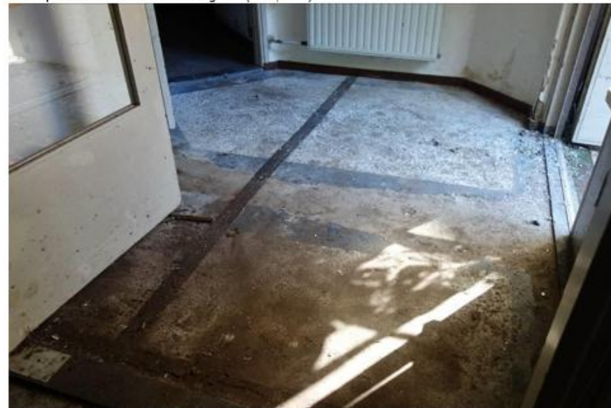
Restanten van de granito vloer bij de noordelijke entree van het hoofgebouw. (MAB, 2019)
