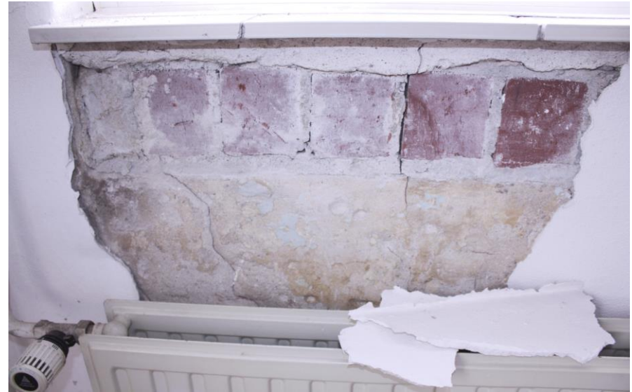
Achter het stucwerk is nog een oudere afwerklaag aanwezig.
