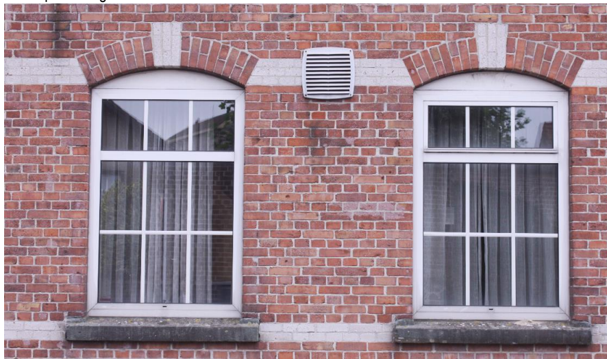
Detail van de vensters zoals die in de gevels van het gebouw voorkomen.
