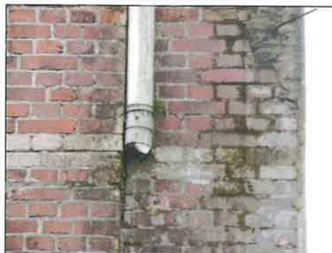
Deels ontbrekende PVC hemelwaterafvoer
