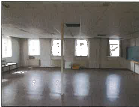
Systeemplafond eerste verdieping
