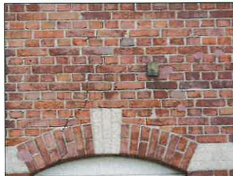
Doorgaande scheur door gevelstenen
