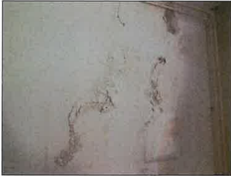
Vochtschade pleisterwerk noordzijde
