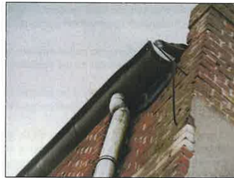
Lekkage aan de zinken goot
