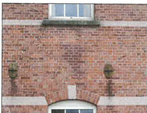
Verticale scheuren tussen de gevelopeningen
