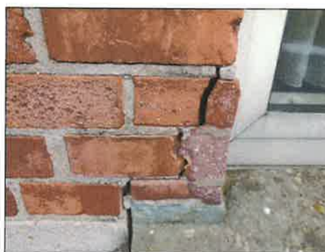
Scheuren dwars door de gevelstenen
