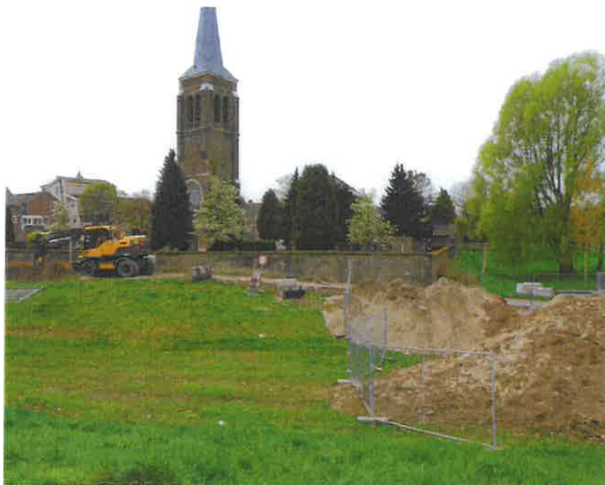
Afb. 2.13 Aanleg van de hemelwaterafvoer ter hoogte van de Gennepershuisweg. Uiterst rechts, tussen de kerkhofmuur en de wilgenboom de voormalige binnenste gracht aan het Melkstraatje. Foto richting het zuidwesten.
