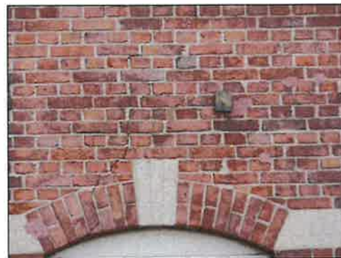
Doorgaande scheur door gevelstenen
