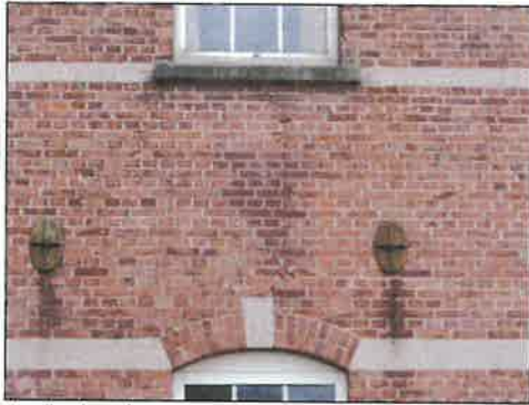
Verticale scheuren tussen de gevelopeningen
