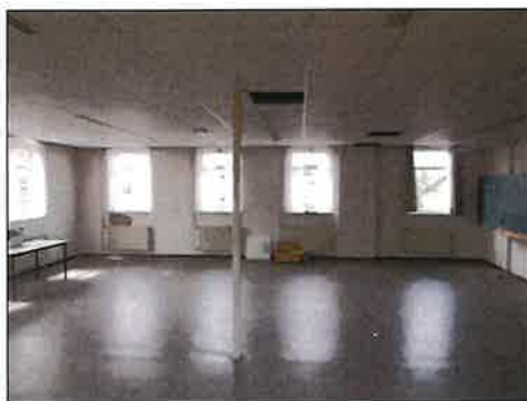
Systeemplafond eerste verdieping
