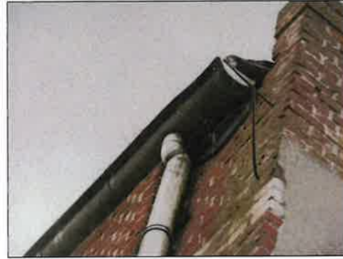
Lekkage aan de zinken goot
