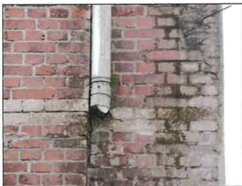
Deels ontbrekende PVC hemelwaterafvoer
