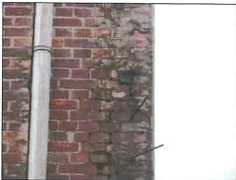
Beschadigde gevel, restanten wapening gesloopt deel
