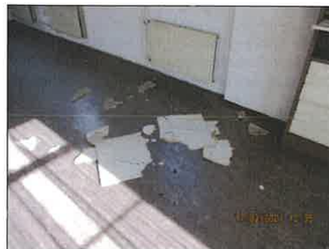
Plafondplaten door lekkage gevallen
