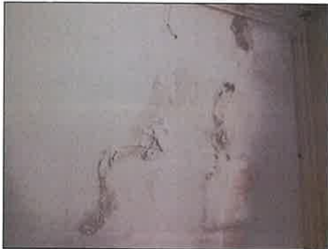
Vochtschade pleisterwerk noordzijde
