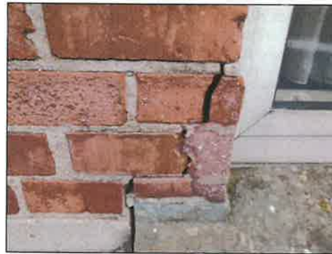
Scheuren dwars door de gevelstenen
