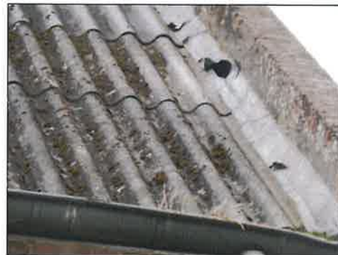
Gebreken aan de loodslabben t.p.v. de gevel
