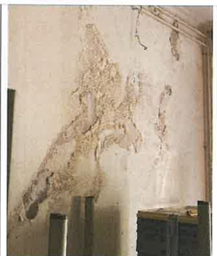
Figuur 14. vocht aan de binnenzijde
