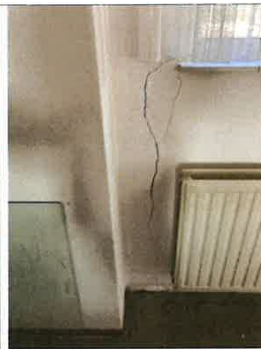
Figuur 18. scheur 4.2 binnenzijde
