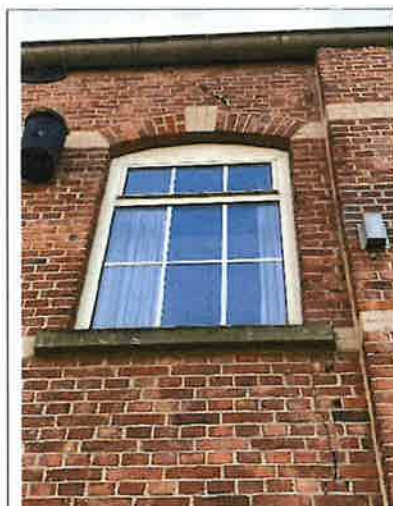
Figuur 16. scheur 4.2 buitenzijde
