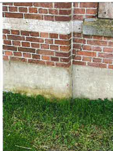
Figuur 17. scheur 4.1 buitenzijde
