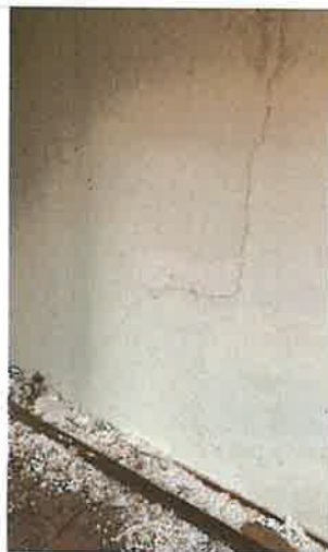
Figuur 13. scheur binnenzijde
