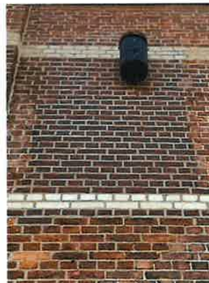
Figuur 3. Ingeboet metselwerk ter plaatse van een sparing
