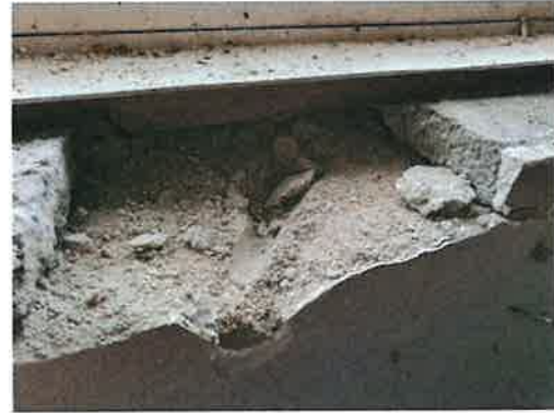
Nabij kozijnen buitengevel
