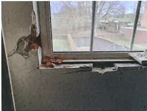
Nabij kozijnen buitengevel
