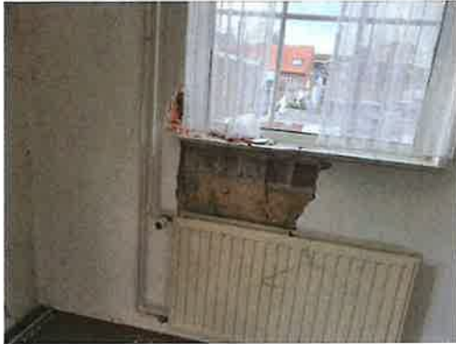
Nabij kozijnen buitengevel
