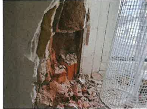
Nabij kozijnen buitengevel
