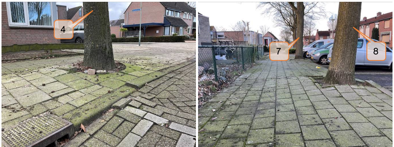
Foto 9 en 10: Beeld van wortelopdruk ter hoogte van de moseik met boomnummer 4 (links) en 7 en 8 (rechts) aan de Prins Hendrikstraat.
