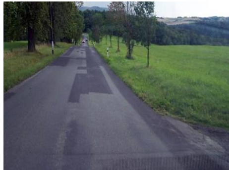
Afb. III.2: Een lappendeken door reparaties klein onderhoud
